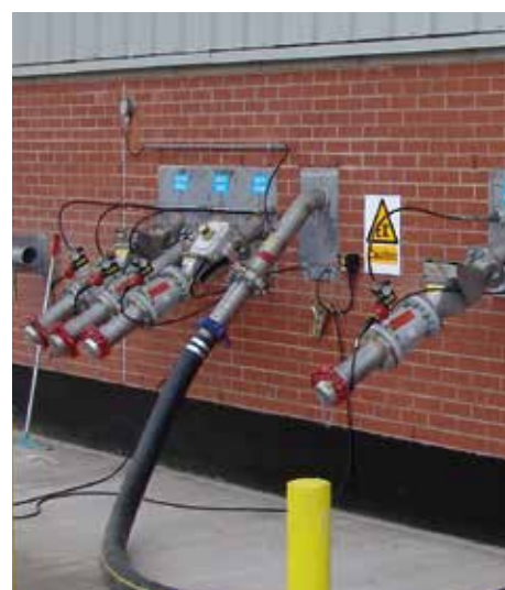
Pneumag installé sur une entrée de matériaux en vrac, certifié ATEX.
